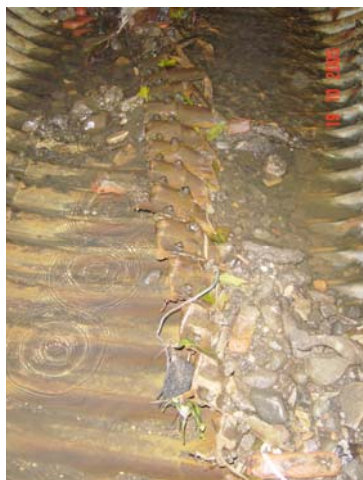
Fotografía 21. Falla en la base de la tubería, en la zona adyacente al tramo de colapso total
