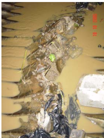
Fotografía 20. Falla en la base de la tubería, en la zona adyacente al tramo de colapso total
