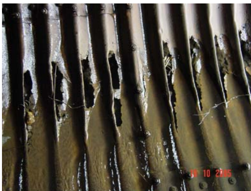
Fotografía 26. Deterioro en la base
