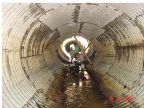
Fotografía 22. Deformación de la estructura de arco
