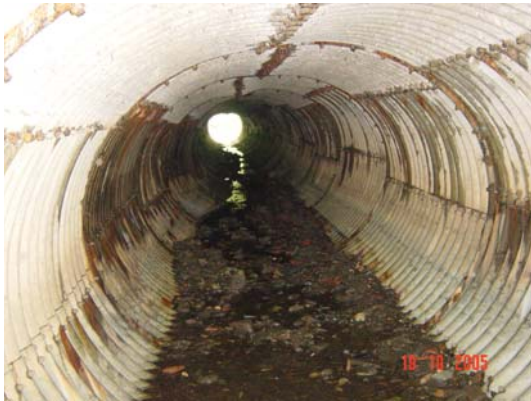
Fotografía 25. Tubería aguas arriba del tramo colapsado.
