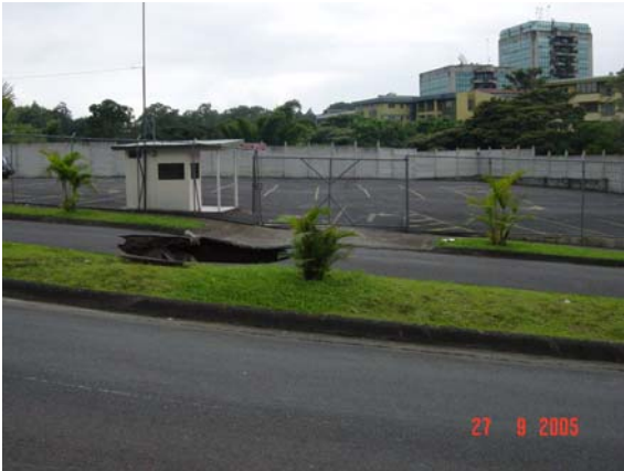
Fotografía 2. Punto superficial del colapso
