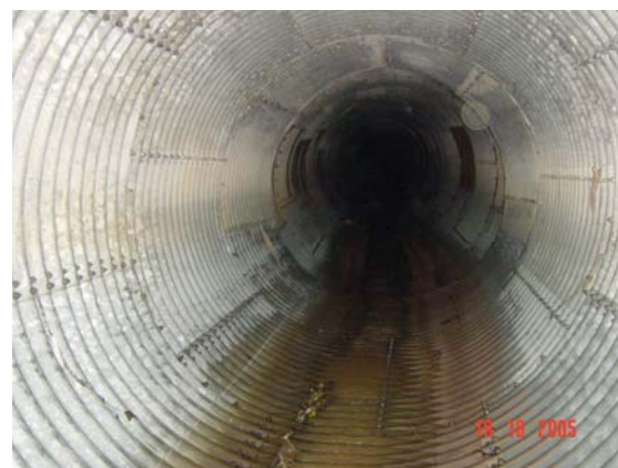
Fotografía 23. 20m aguas abajo del tramo colapsado
