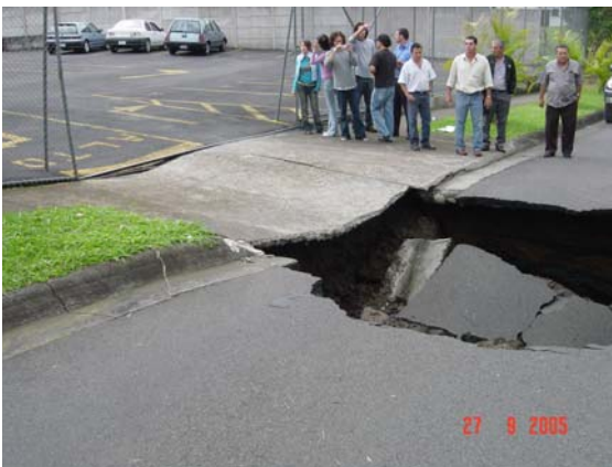
Fotografía 7. Punto superficial del colapso
